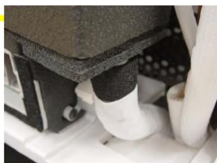
TUBAZIONE DI SCARICO
