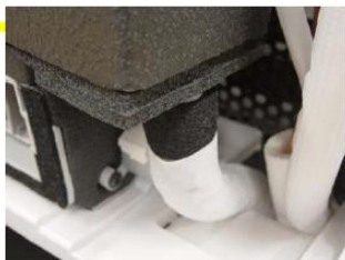
TUBAZIONE DI SCARICO
